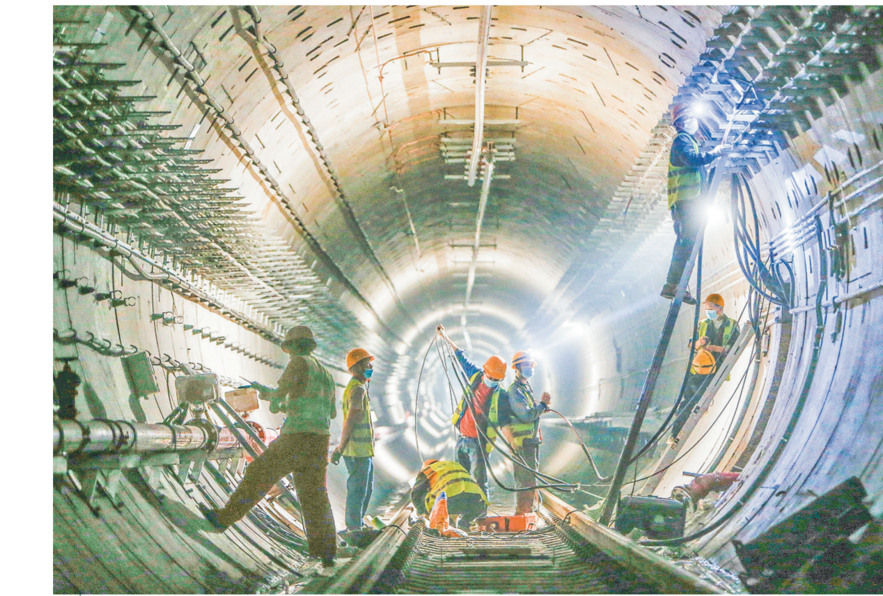
9月1日,由中铁十一局、中铁十四局、中铁十八局等单位参建的西安地铁5号线开始试运行。该线全长25.36公里,是西安东西向骨干线路。图为在地铁机电设备安装施工中,中铁十四局电气化公司施工人员在隧道内进行区间放线、支架安装。
